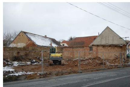
Zbořeniště domu čp. 144 (foto autor článku, leden 2021).
